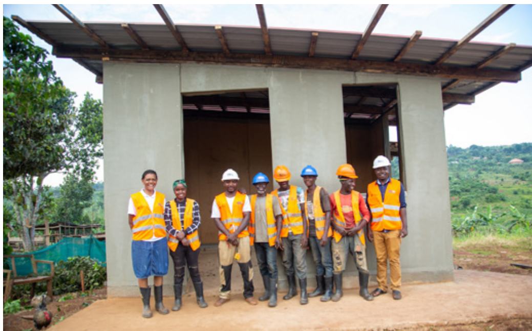
Juni 2021: Das Bauteam freut sich über einen fast fertigen Abschnitt des Frauenzentrums. Foto: Nyokabi Kahura/Malteser International
