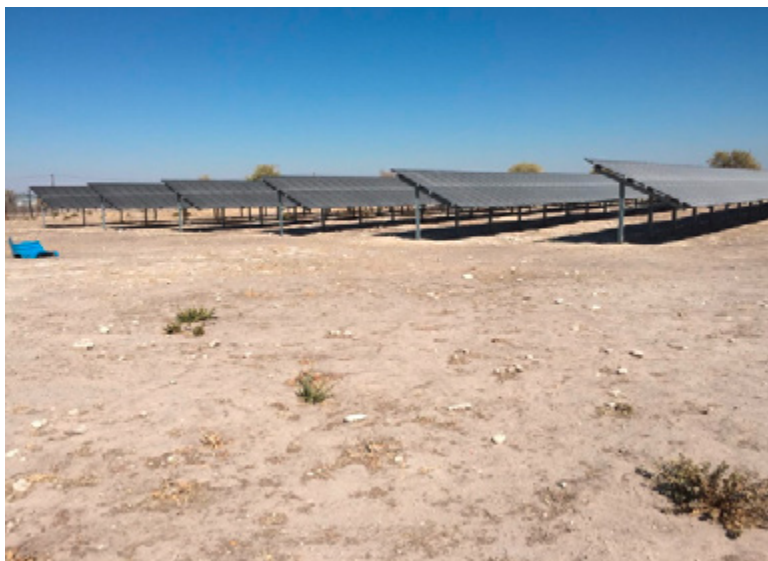
Abbildung 1: Tsumkwe, Namibia, Solarmodule des Mini-Grids
